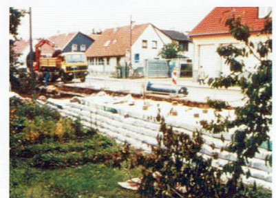
Abb. 2: TenCate Polyfelt bewehrte Stützmauer in Illmenau / Thüringen. Die Gesamtkosten von € 29.000 und die Bauzeit von 12 Tagen waren entscheidend für die Wahl von Polyfelt gegenüber einer konventionellen Betonstützmauer (Kosten € 64.000, Bauzeit 30 Tage).
